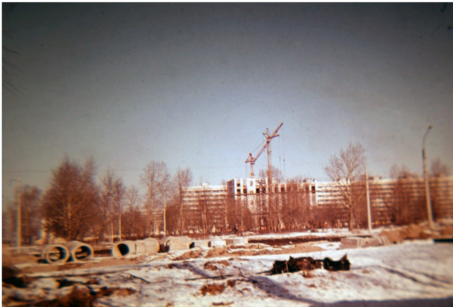
Строительство АТС на ул. Отважных, д. 10, 1971–1976 годы Фото предоставлено Игорем Тиграновичем Акопяном
