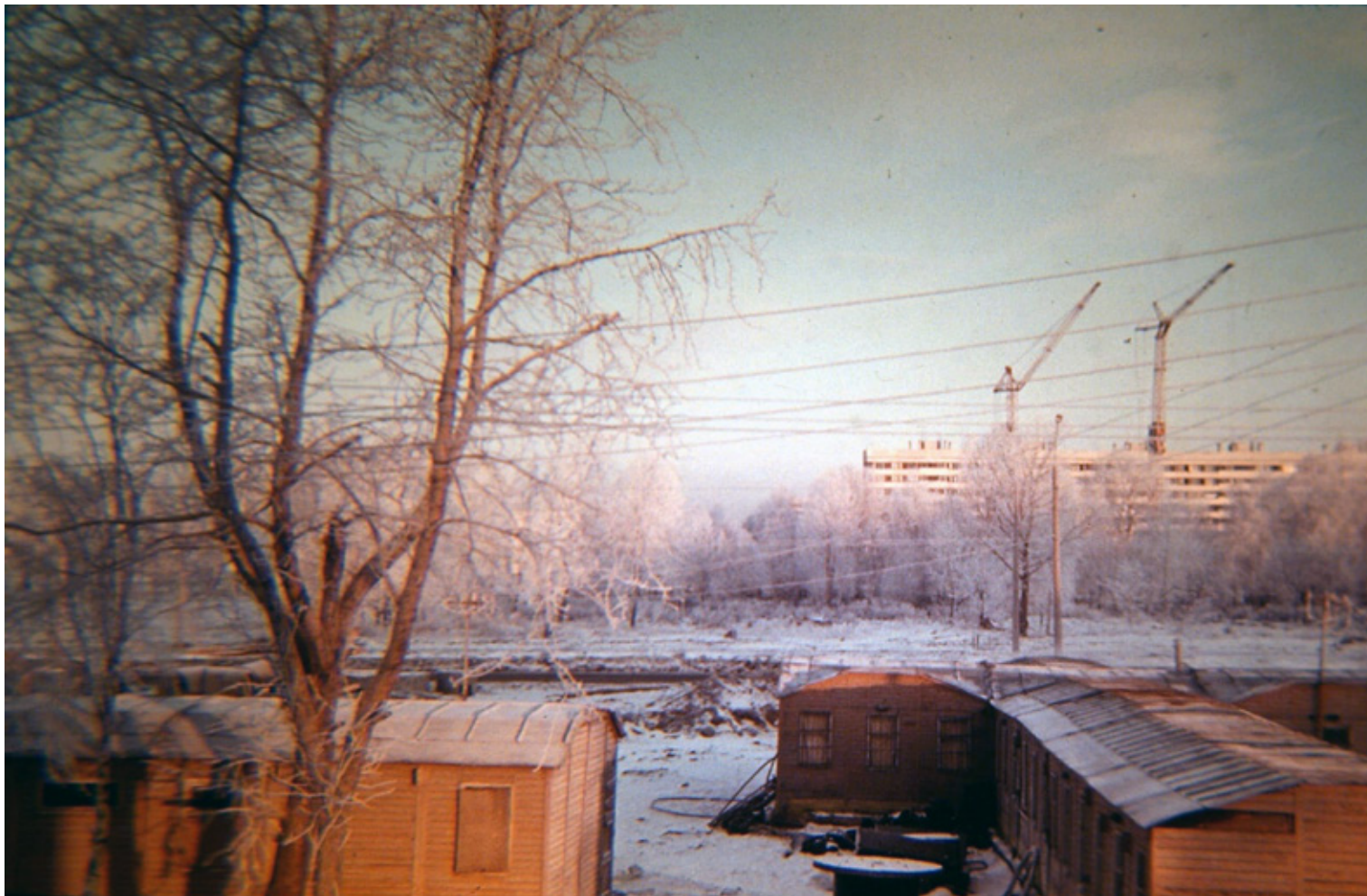
Строительство городской поликлиники № 91, вид с ул. Добровольцев на пр. Ветеранов, 1972–1973 годы Фото предоставлено Игорем Тиграновичем Акопяном
